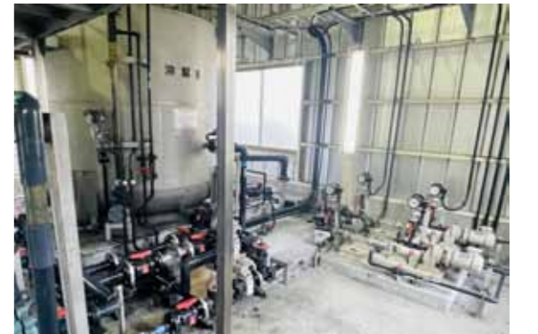
県が所有する活性炭処理設備
