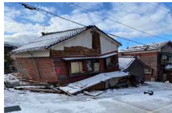
令和6年能登半島地震で倒壊した木造住宅
